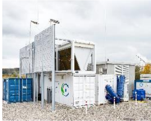
Wasserstoffproduktion durch Elektrolyse
